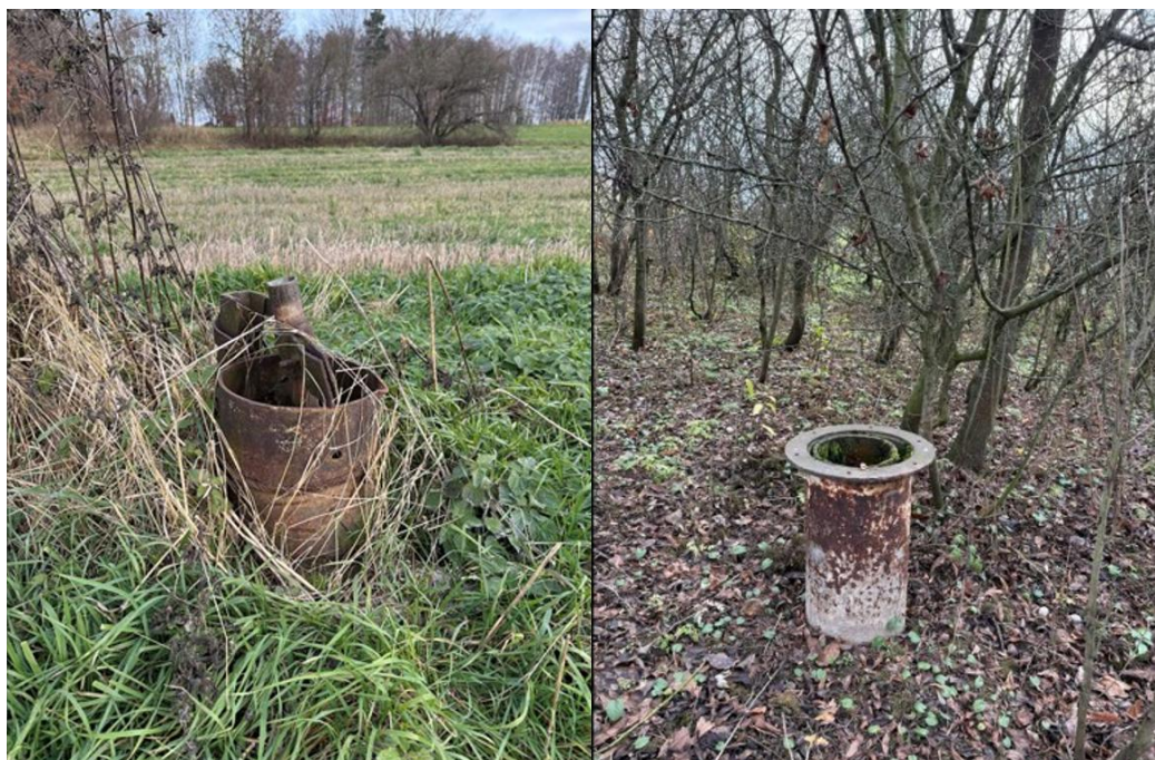
Obr. 2 Zcela nezajištěné vrtý O-1 Osík a PK-1 Pekla, zařazené do projektu Likvidace nepotřebných vrtů v rámci výzvy SFŽP ČR č. 23/2025
